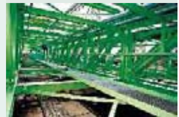
■ Rohrbrücken für Kokerei Schwelgern
